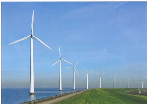
Fot. 1. Turbiny wiatrowe o wysokości gondoli przekraczającej 100 m
