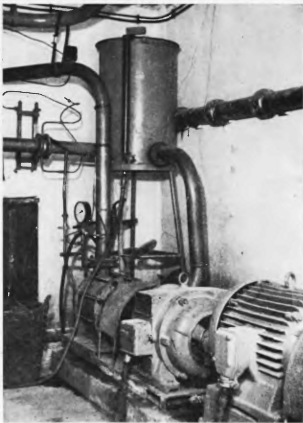
Rys. 8. Ogólny widok stacji pomp
